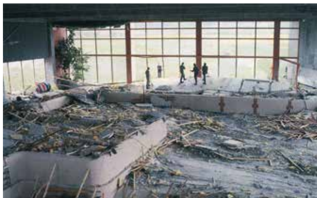
En 1985, le plafond suspendu en béton d'une piscine couverte s'est écroulé à Uster, en Suisse. Les fixations du plafond, en acier inoxydable A2, n'ont montré aucun signe de défaillance quel qu'il soit, bien que certaines soient entièrement détruites intérieurement, en raison de fissures de contrainte liées à la corrosion.
