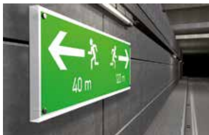
Panneaux d'issue de secours dans les tunnels
