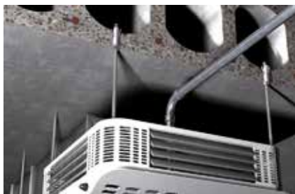
Climatiseurs dans les dalles alvéolaires
