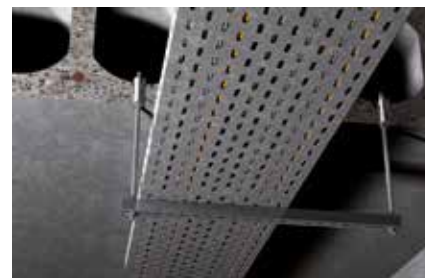
Chemins de câbles dans les dalles alvéolaires
