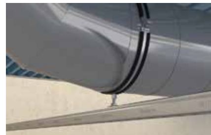
Structures portantes pour installations de ventilation
