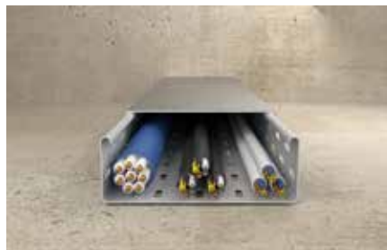
Application électrique en dalle
