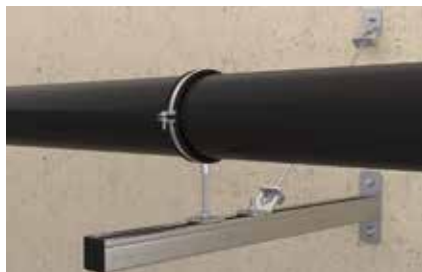
Tuyauterie lourde d'eaux usées sur console
