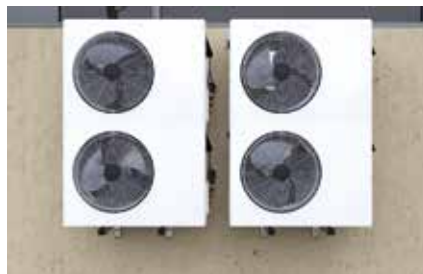
Unités de climatisation
