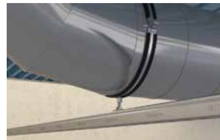
Structures portantes pour installations de ventilation
