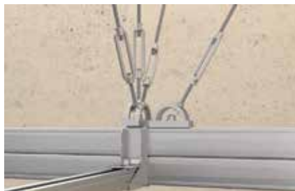
Haubanage de rails pour plafonds techniques
