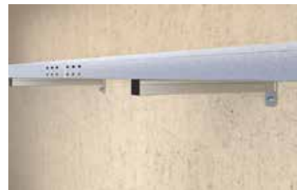
Chemin de câbles fixé par consoles
