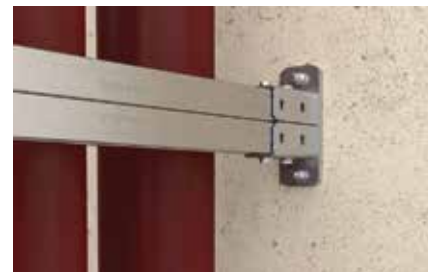
Haubanage pour point fixe
