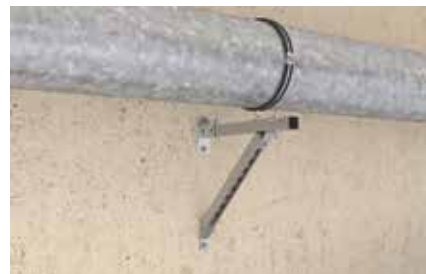
Gaine de ventilation sur console
