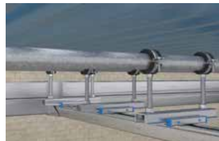
Coulisseau sur plafond technique
