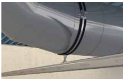
Structures portantes pour installations de ventilation
