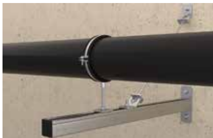
Tuyauterie lourde d'eaux usées sur console
