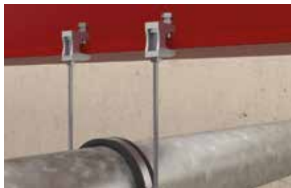
Tuyau d'évacuation lourd sur pince à poutrelle
