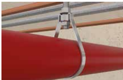
Fixation de sprinkler
