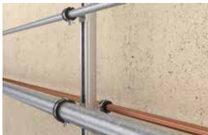
Montage latéral de tubes sur rails
