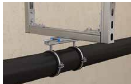
Système de dilatation avec coulisseau et tuyauterie suspendue
