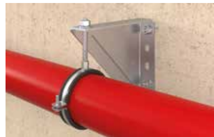
Tuyau d'évacuation lourd suspendu sur console équerre
